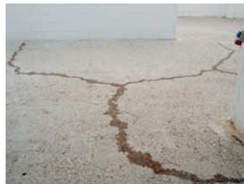
Mit Epoxydharz verschlossene Risse in der Betonplatte.
